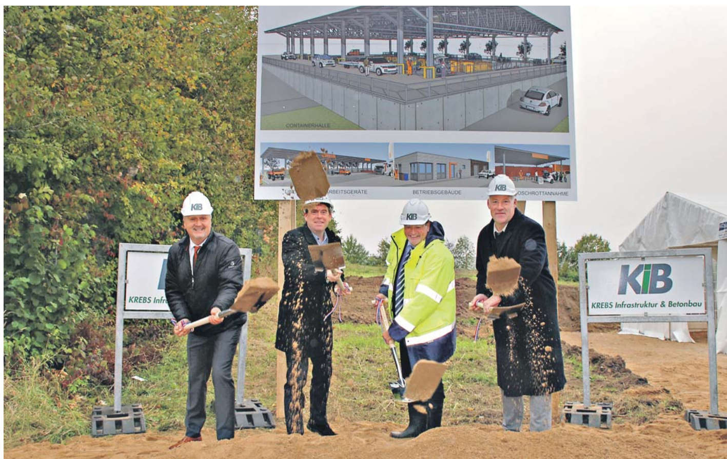
Für den neuen Wertstoffhof in der Clara-Immerwahr-Straße haben die Bauarbeiten begonnen. Den ersten Spatenstich setzten Dariusz Manczuk vom Planungsbüro Zwerk Architektur GmbH, Oberbürgermeister Ulf Kämpfer, ABK-Werkleiter Enno Petras und Matthias Neumann, Geschäftsführer von KIB Krebs Infrastruktur & Betonbau (von links). FOTO: KARIN JORDT
